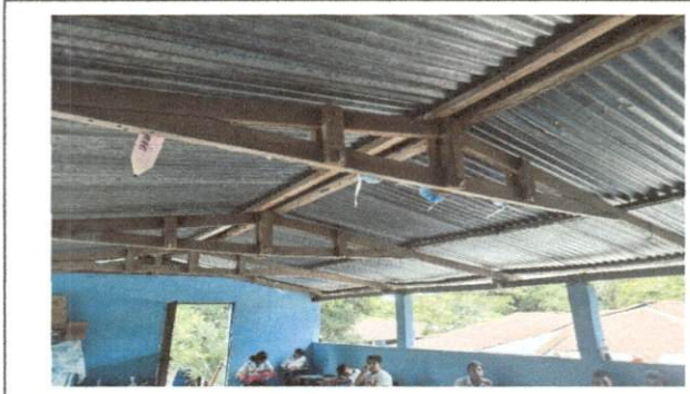
Foto 8 :MODULO B Cambio de lamina y estructura de madera por estructura de metal y lamina troquelada cal 26.
