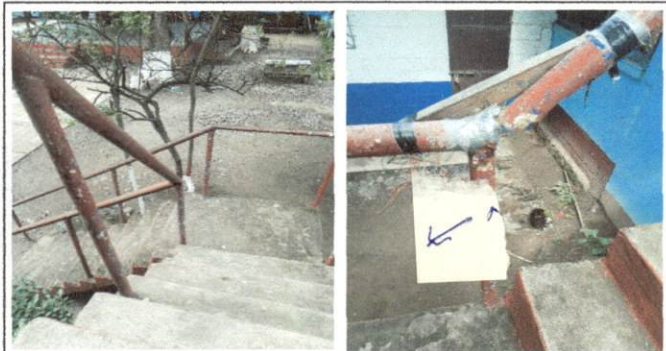
Foto 9: MODULO B Suttitucion de baranda metalica en mal estado
