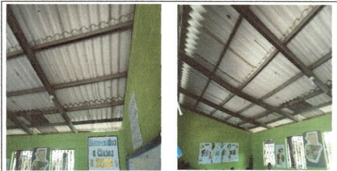
Foto 6: MODULO A Vista interna de cubierta de asbesto con estructura de madera, a sustituir por estructura de metal con lamina troquelada cal 26.
