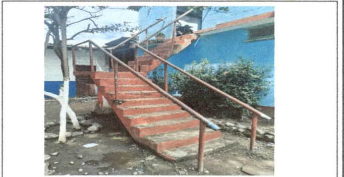
Foto 10: MODULO B Gradas de concreto en malas condiciones estructurales y huella y contrahuella desproporcionadas. Suttitucion de baranda metalica existente.
