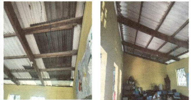
Foto 4: MODULO A Vista interna de cubierta de asbesto con estructura de madera, a sustituir por estructura de metal con lamina troquelada cal 26.
