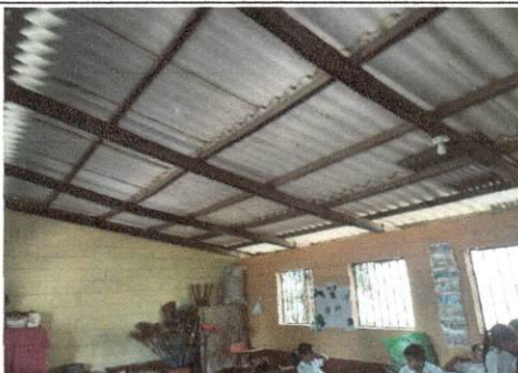
Foto 5: MODULO A Vista interna de cubierta de asbesto con estructura de madera, a sustituir por estructura de metal con lamina troquelada cal 26.
